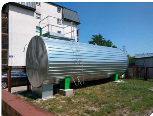
Zbiornik na wodę uzdatnioną przygotowaną do wpompowania do sieci w okresie szczytu poboru
