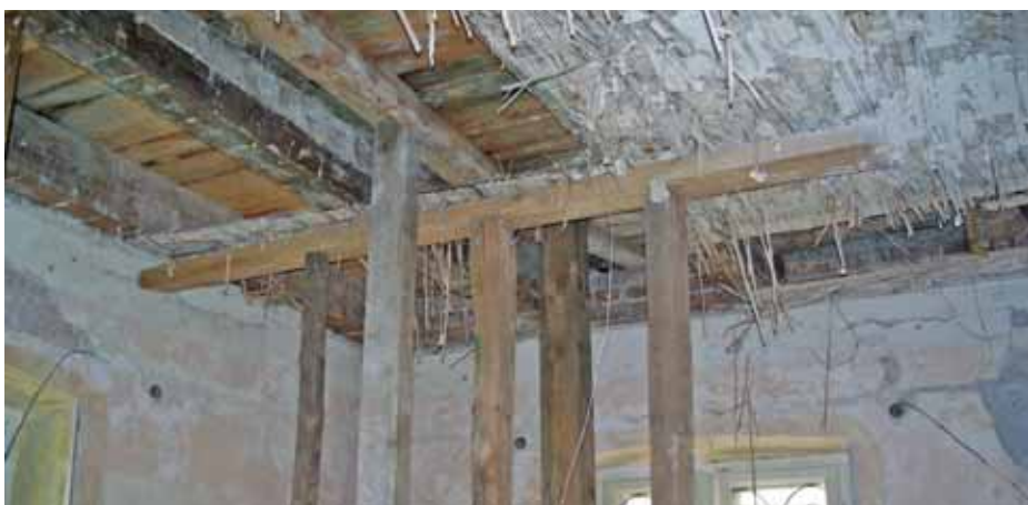
Stropy budynku są w fatalnym stanie
